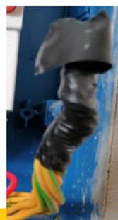
Connexion non fiable par épissure sans dispositif de connexion (pt 41)
