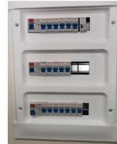
Obturbateurs manquants au tableau sous tension
