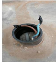
Conducteurs du circuit éclairage extérieur, sous tension en attente de raccordement
