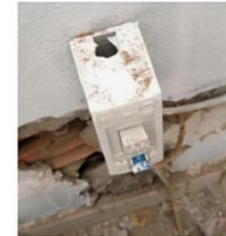
Coffret surpresseur sous tension-enveloppe cassée
