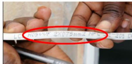
Section minimal du circuit éclairage extérieur insuffisant (HO5VVF 2x0,75mm 2 (pt 42)
