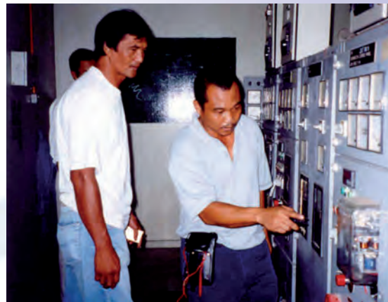
"Une personne compétente" en train d'inspecter un relais de protection sur un panneau de commande général.
